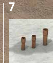
7 貫穿件漏水 (如貫穿管處)
