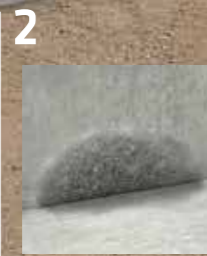
2 空洞區域漏水 (如蜂窩等)
